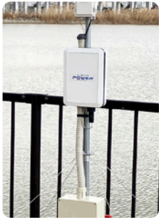
ため池監視システム (兵庫県明石市)
