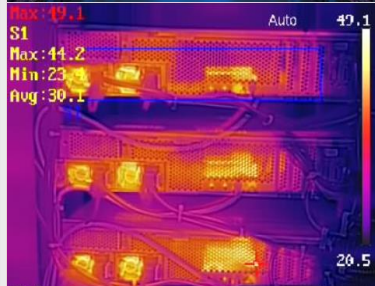
データセンター
